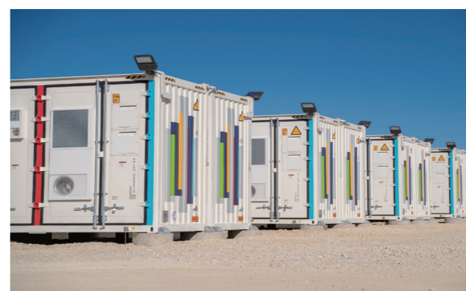
Texas, USA 226MWh Régulation de fréquence
